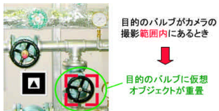
図 3.5: 作業対象バルブがカメラ撮影範囲内にある場合の情報提示
